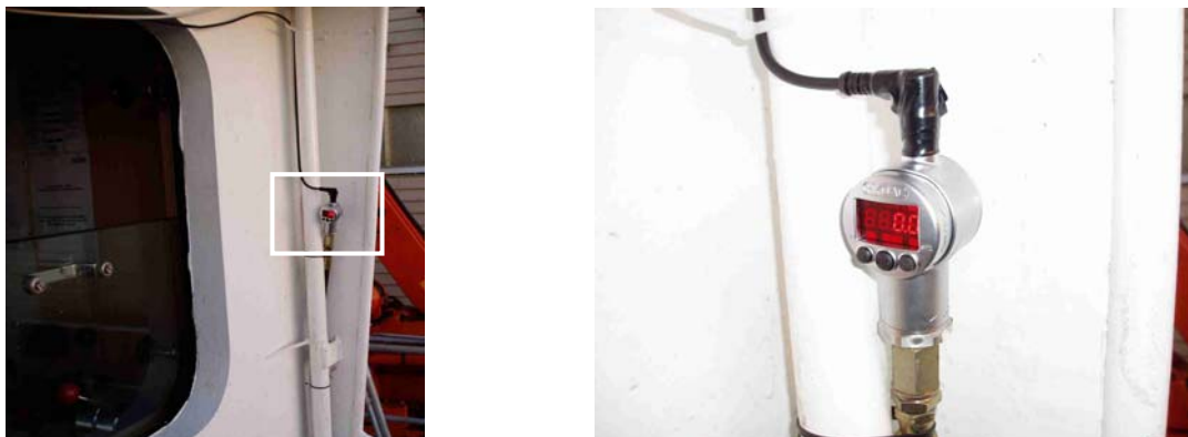
Fig. 5 Trykkmåler/bryter med digital visning av trykk, plassert i bakkant av styrehus
